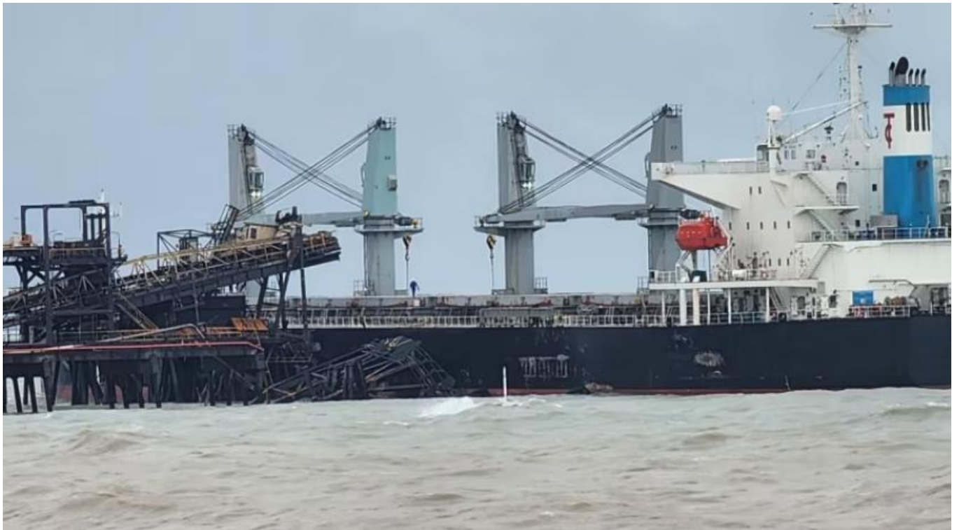
图 1 装卸码头损坏现状
